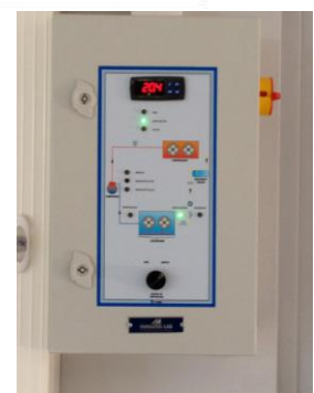
Cuadro de control cámara de frío
